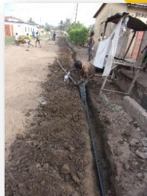
2017 Réalisation de l'adduction d'eau et de l'assainissement du nouveau centre médico-social de Notsé
